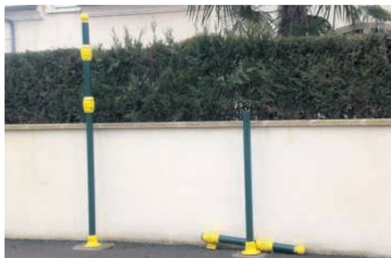
VERT-LE-GRAND, MARDI. Les agents municipaux ont constaté qu'un des poteaux avait été sectionné.
